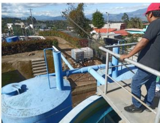
Ilustración 7 Planta de tratamiento
